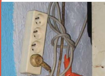
Installation électrique dangereuse
