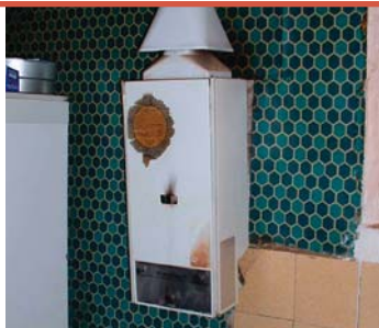
Absence de dispositif d'évacuation des gaz brûlés
