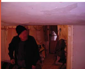
Hauteur sous plafond insuffisante
