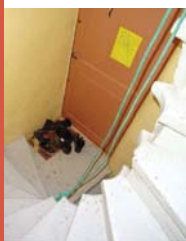
Absence de dispositifs de retenue des personnes
