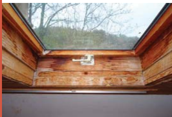
Absence de protection contre les infiltrations d'eau
