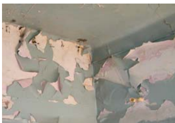
Peinture écaillée contenant du plomb
