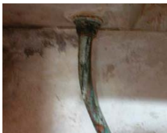
Absence de siphon
