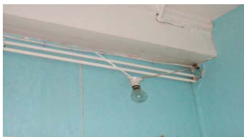
Eclairage insuffisant et dangereux
